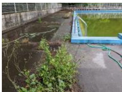
Before 木が生えていました…
